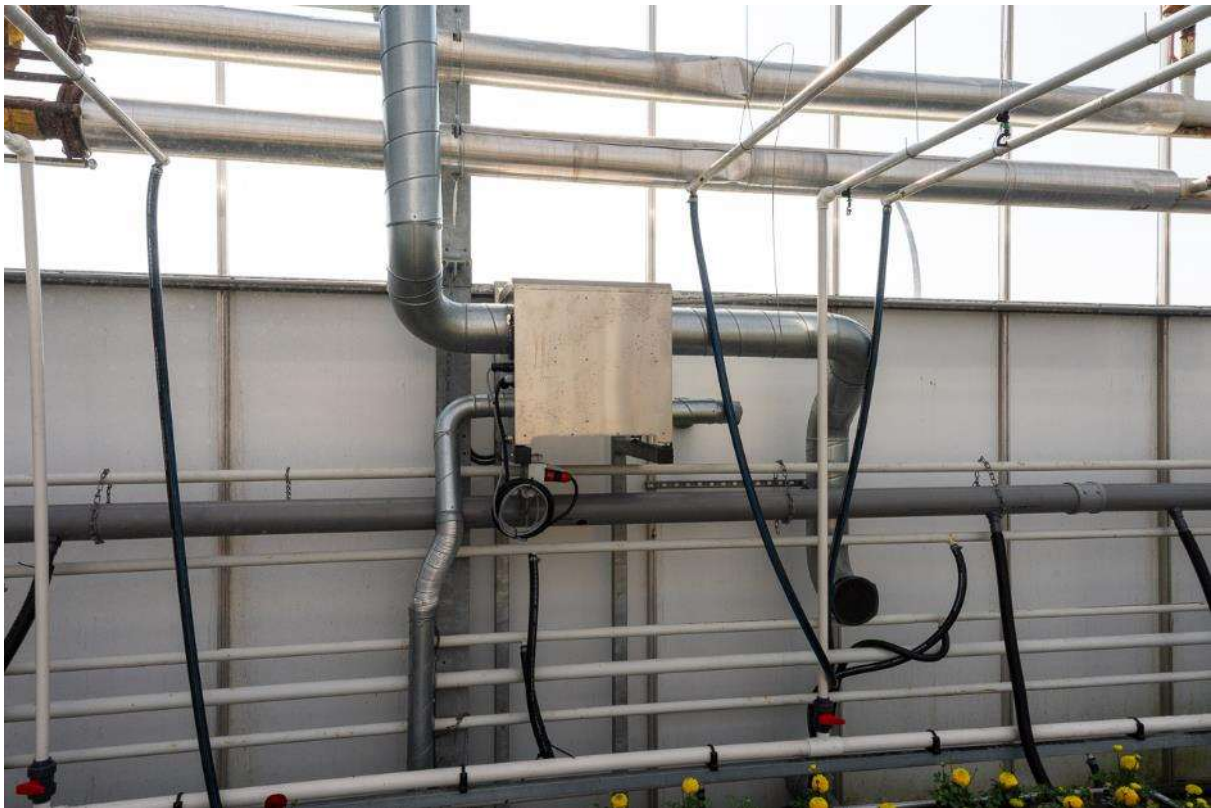
Figuur 1: De geïnstalleerde condair adsorptiedroger in afdeling 3.2 op het Delphy Improvement centre.
