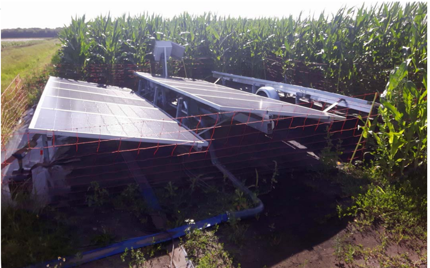
Directe stroomopwekking met zonnepanelen voor druppelirrigatie; hierdoor is er alleen overdag energievoorziening.
